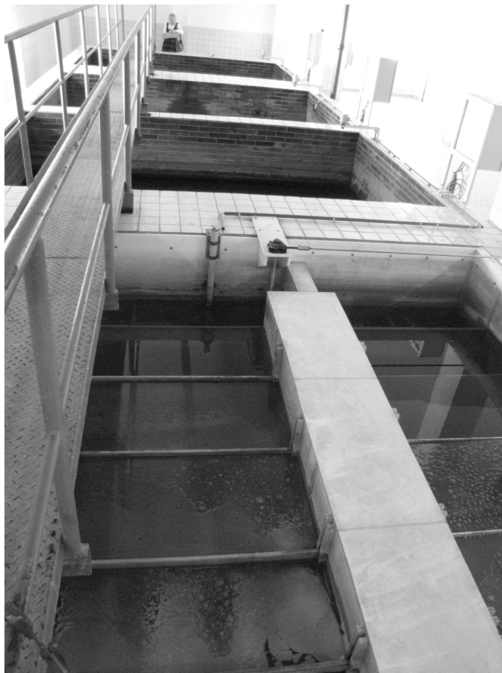
Obr. 1. Tzv. nová úpravna - v popředí nádrž s děrovanými stěnami (podzemní voda vlevo), za ní 3 pískové filtry
